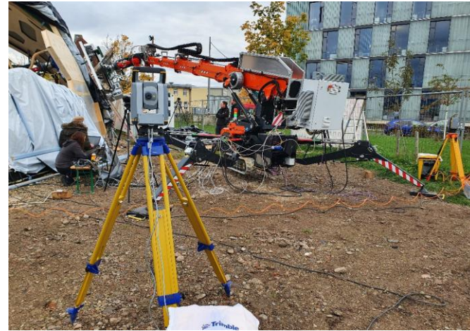
Kran / Roboter B
